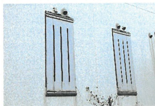
ランチルームトイレ前の窓板
